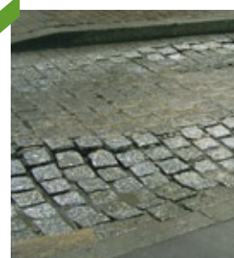
Déformation et enfoncement de la zone pavée
